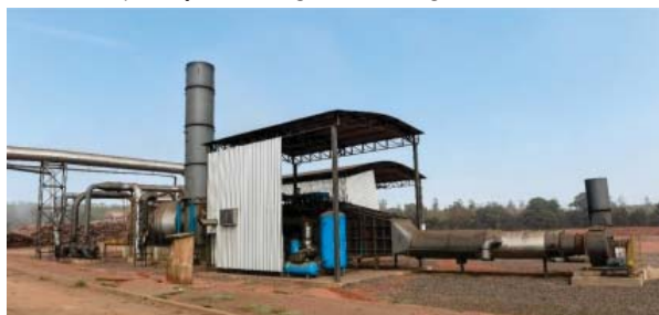
Figura 49 - Queimador dos gases residuais desenvolvido no projeto de P&D Cemig GT 358 (PD-4951-0358/2010), em parceria com a ArcelorMittal BioFlorestas. - Fonte: Cemig.
