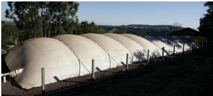
Figura 66 - Biodigestores do tipo canadense. Foto - Unidades de Captação de Biogás. Divulgação/Eletrosul. | www.wp.clicrbs.com.br
