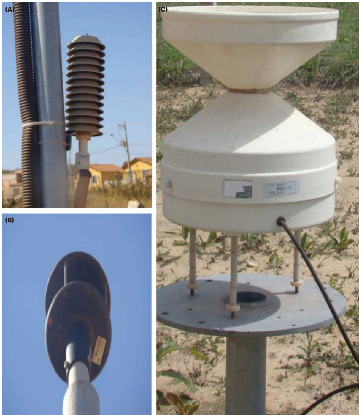
Figura 25 . (A) detalhe termohigrômetro HMP-155, umidade relativa do ar e temperatura ambiente, instalado à 2,0 metros em relação ao solo; (B) anemômetro/Biruta SD1-12, direção e velocidade do vento instalado a 10 metros em relação ao solo; (C) pluviômetro QMR-102, precipitação instalado a 0,5 metro em relação ao solo.
