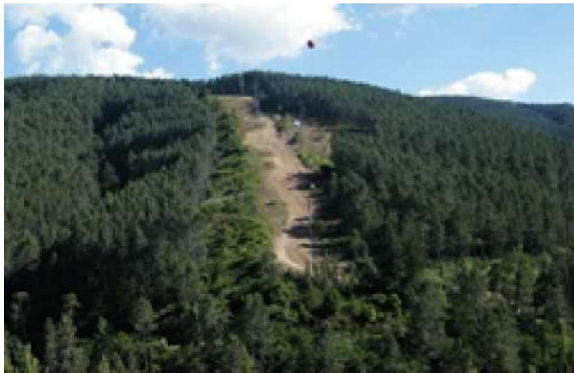
Figura 43 - Faixa de gestão de combustível da rede elétrica de muito alta tensão.
