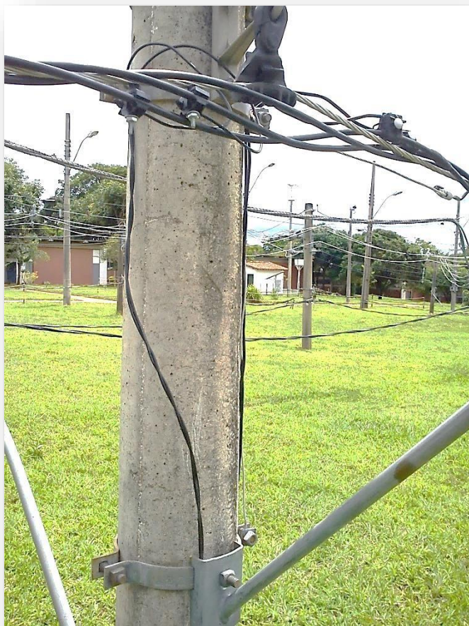
Foto 1 – Montagem do novo padrão de aterramento e ligação da iluminação pública. O cabo deve ser trançado e sair por cima do braço de IP.
