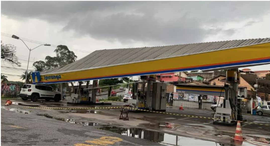
Vento derruba teto de posto de combustível em BH — Foto: Manoela Borges / TV Globo
