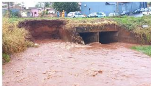
Temporal alaga Ituiutaba e provoca alagamentos — Foto: Corpo de Bombeiros
