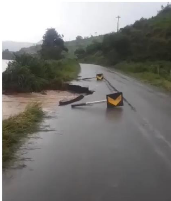
Trecho foi interditado depois que parte da pista da MG-105 foi levada pela força da correnteza — Foto: Polícia Militar Rodoviária
