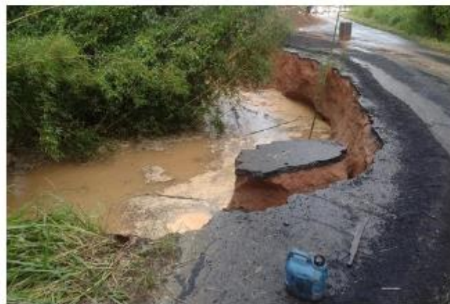
Trecho da MG-133 onde cratera voltou a abrir no km 23 — Foto: PMR/Ovulgação
