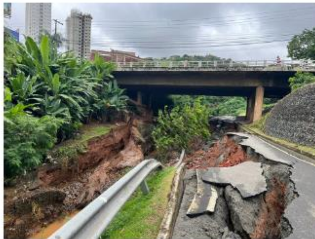
Cratera se abriu após chuva no bairro Iguaçu em Ipatinga — Foto: Juana Sales/Inter TV dos Vales
