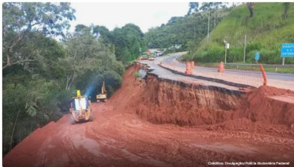
Trecho de BR 040 em Serra dos Gramma, que desabou
