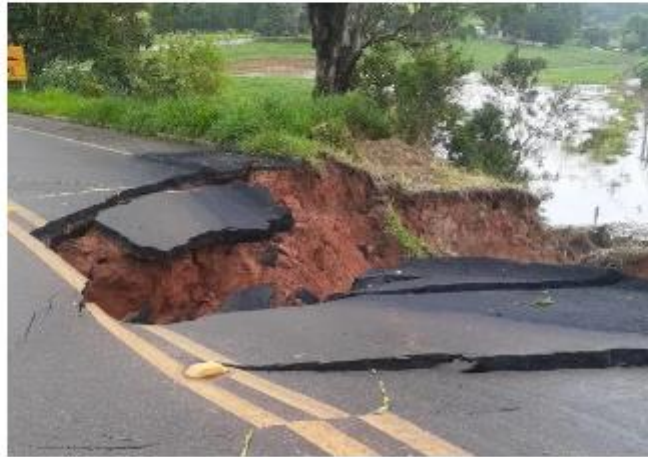
Trecho da MGC-460 é interditado após cratera se abrir na rodovia, em Carmo de Minas, MG — Foto: Divulgação/PMR
