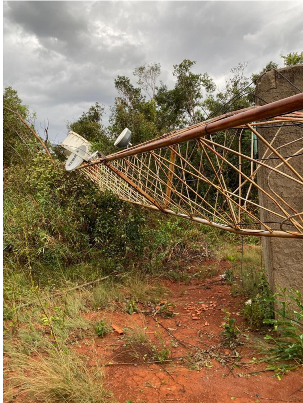
Figura 3: Torre de telecomunicação derrubada pelo vendaval que atingiu a região.
