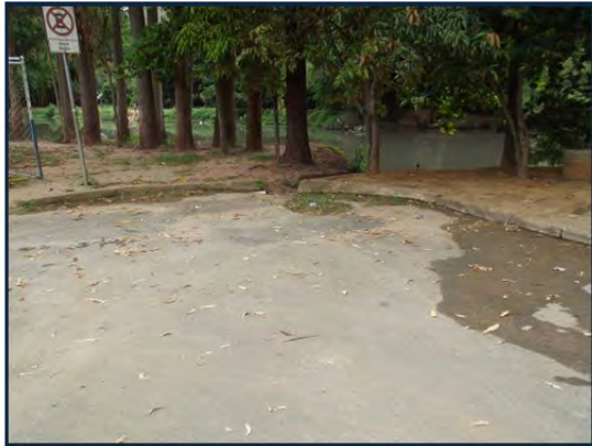
Foto 3 - Margens do reservatório no Bairro Bethel. Há uma via perimetral entre as edificações e o reservatório que permite acesso às águas. Ponto sujeito a inundações em épocas de cheias.
