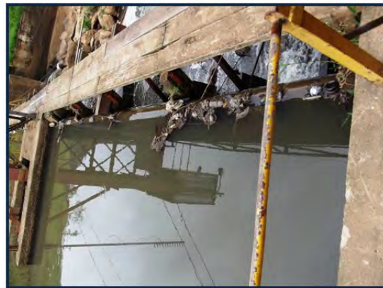
Foto 28 - Lixo que se acumula na barragem e águas turvas pelo excesso de esgoto.
